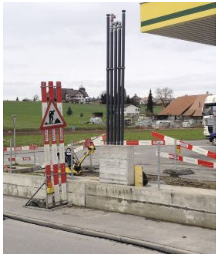
Abb. 1: Druckausgleichsleitungen einer Tankstelle.
